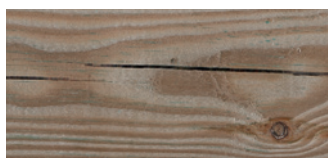
Spanningsscheurtjes door de houtdroging
