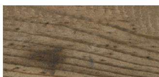
Schimmelvlekken en lichte schimmel
